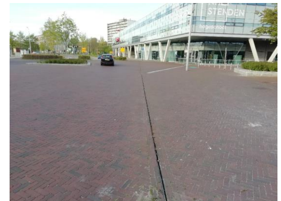
Figuur 8.9 – Lijngoot als duidelijke scheiding (eigen foto)
